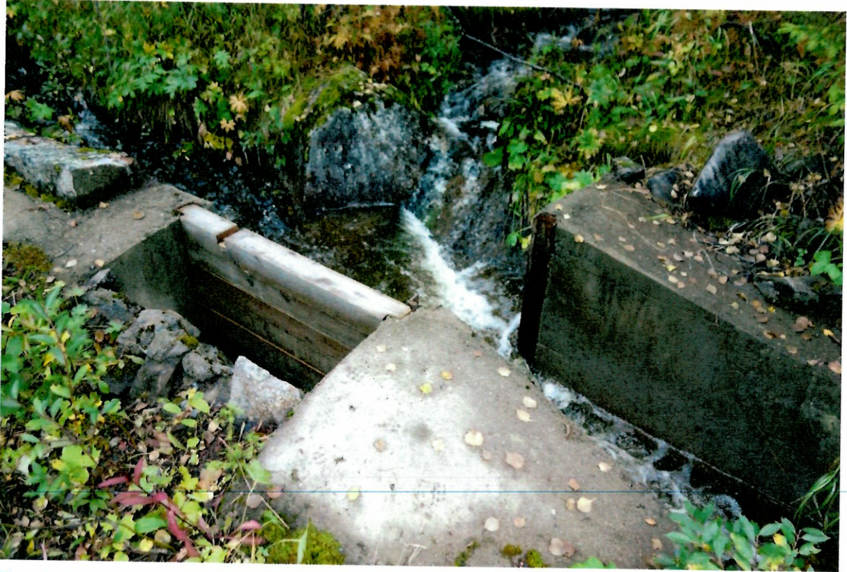
Figur 8. Kulvert med to løp som er etablert ved veien på sørsiden av anlegget.
