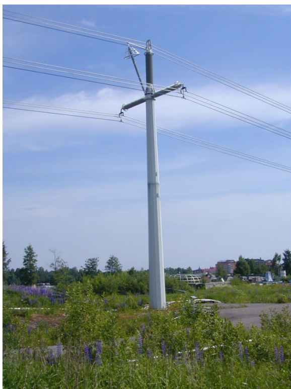
Figur 11 Bildet viser en mast av typen Compact Plus
