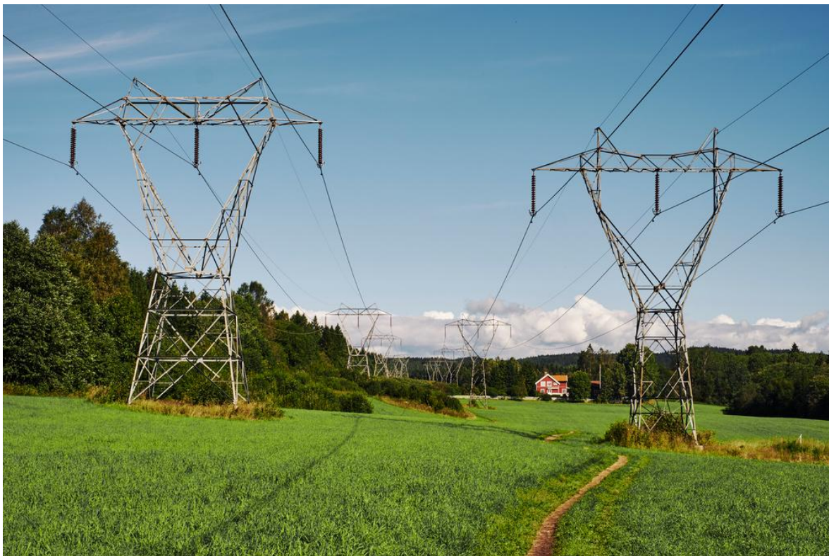
Figur 31. Eksempel på parallelle kraftledninger med lik avstand mellom mastepunktene. Lik masteavstand oppfattes ofte som den mest ryddige løsningen når kraftledninger går parallelt i terrenget. Bildet er tatt i Oslo og viser ledningene på 300 kV mellom Nesbyen – Sogn og Hemsil 2 – Sogn. Foto: Statnett
