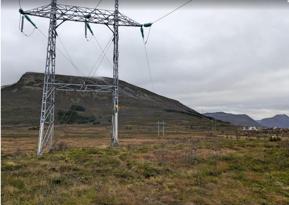
Ledningen inn mot Muffestasjon
