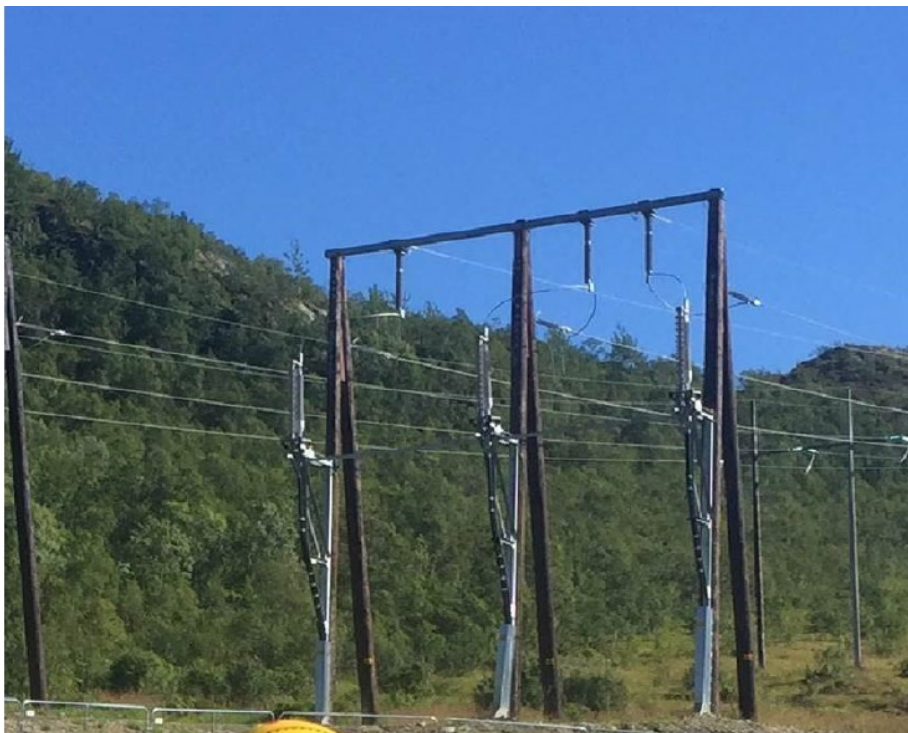
Figur 29: Eksempel på en kabelendemast. Foto er tatt ved Kvitfossen transformatorstasjon i Vågan kommune.
