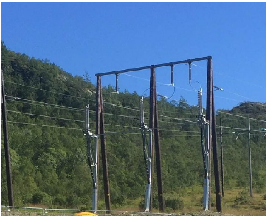
Figur 5: Eksempel på en kabelendemast. Foto er tatt ved Kvitfossen transformatorstasjon i Vågan kommune.
