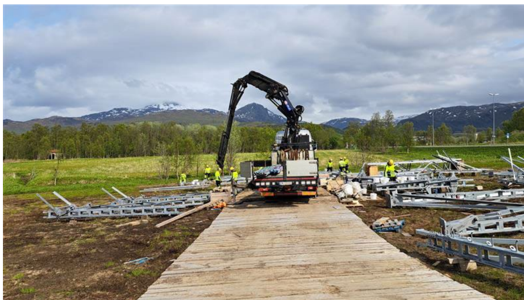
Figur 17: Anleggsplass med lossing og premontering av mastestål hvor det er benyttet stokkmatter som terrengforsterkning for transport.
