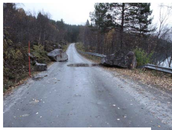
Figur 1.3: Steinsprang dokumentert av Siso Energi
