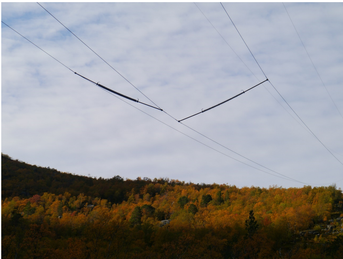
Figur 4.4-7 Faseavstandsholdere for å forhindre sammenslag mellom linene i sterk vind. Ved Svartvatnet på Tjeldøya.
