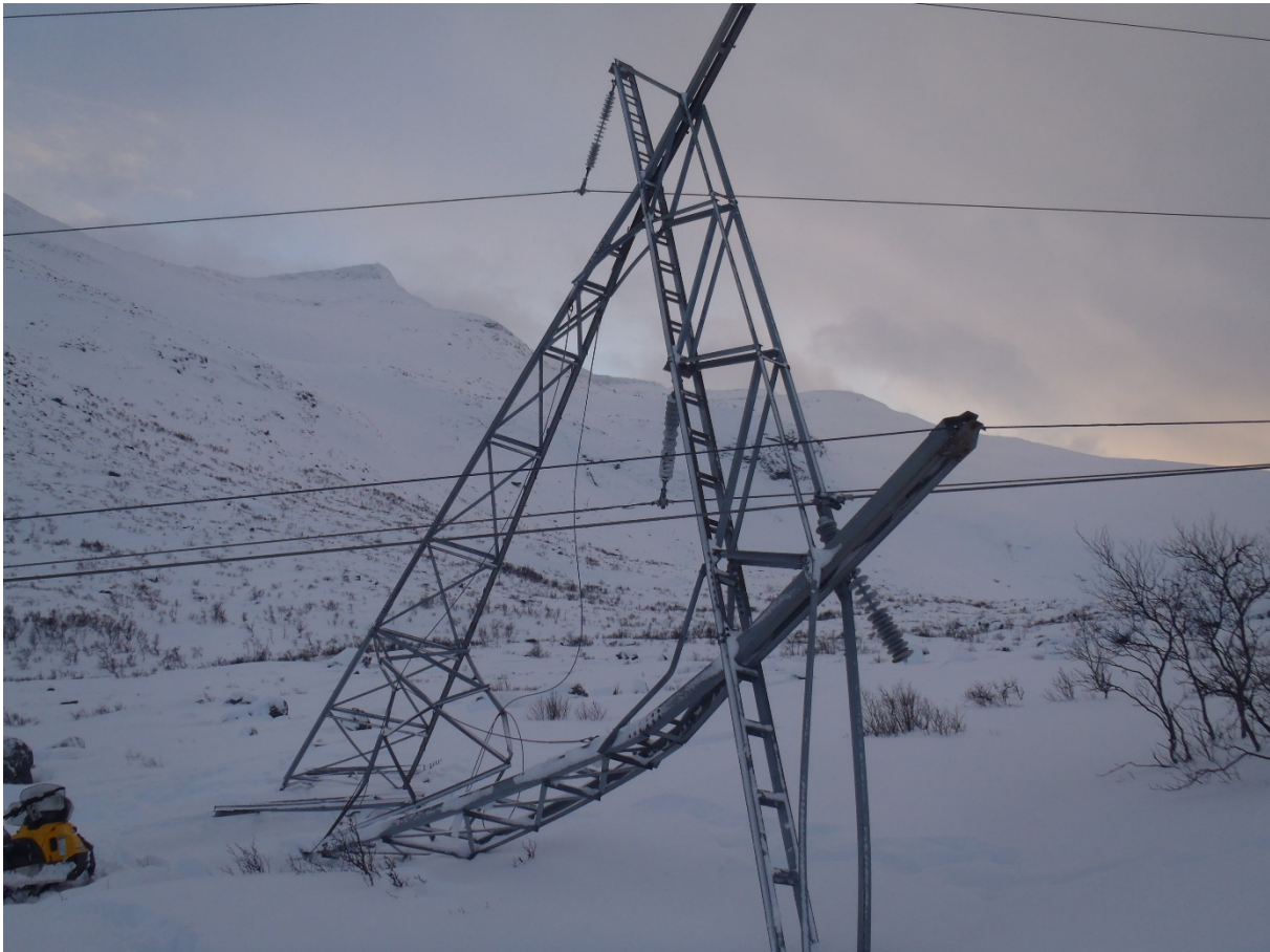
Figur 5.1-3 Etter havari på Tjeldøya 2. mars 2011 da det blåste orkan med opp til 77 knop i kastene. (Kilde: Statnett)
