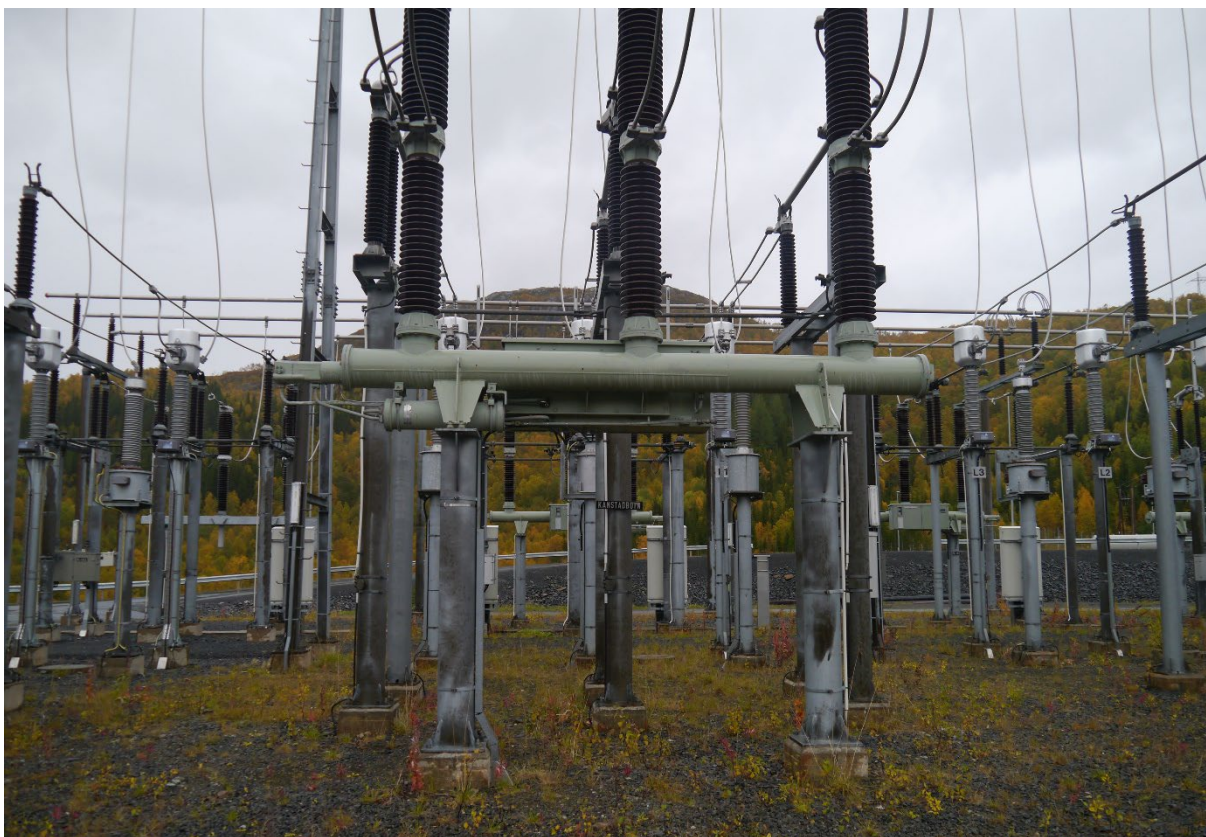
Figur 4.5-1 Fra koblingsanlegget i Kvandal
