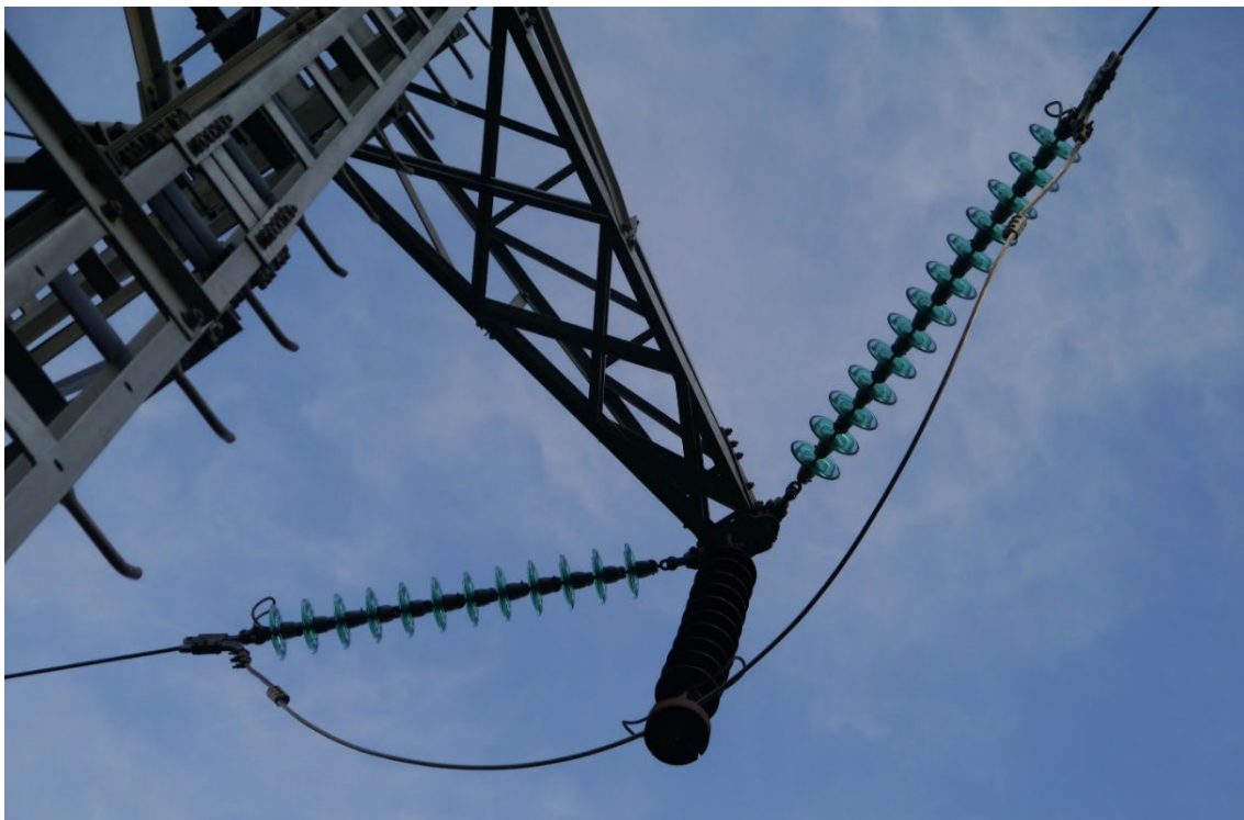
Figur 4.4-4 Armatur på en vinkelforankringsmast: Loop med lodd og støtteisolator i komposittmateriale. Armaturet består av sjakler, opphengsbolt, isolator, avspenningsklemme.
