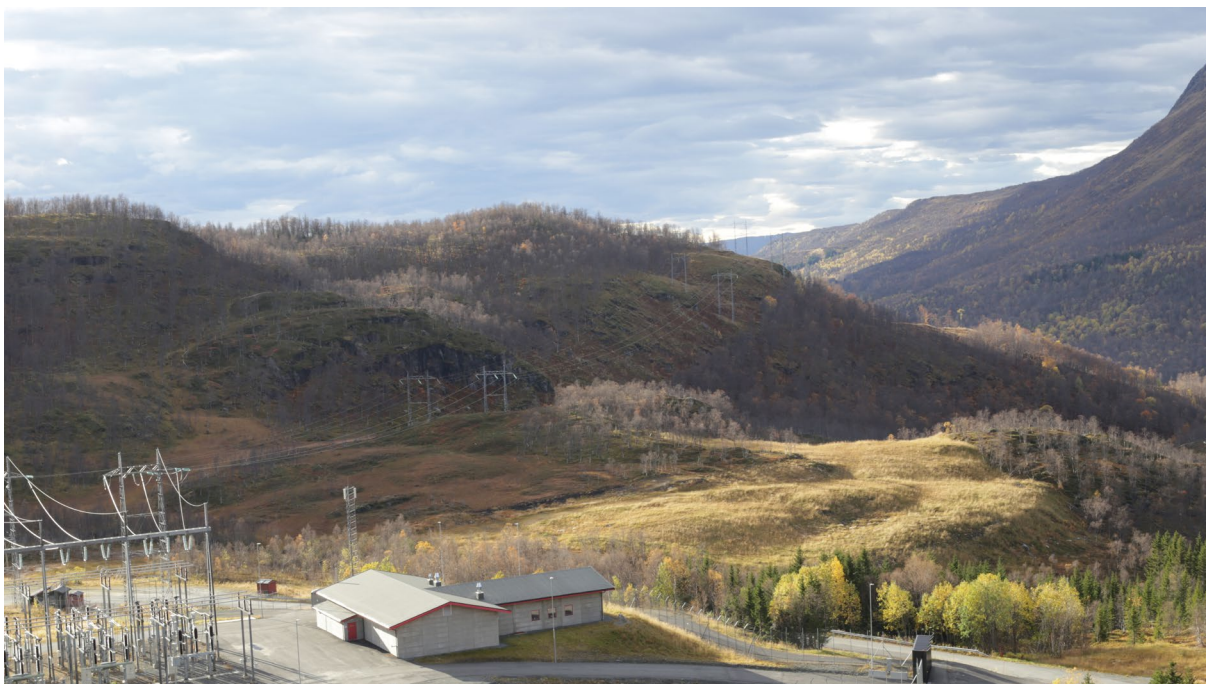
Figur 3.1-2 Kvandal koblingsstasjon sett mot sørvest i 2020. Ledningen til Kanstadbotn er nr to fra høyre.
