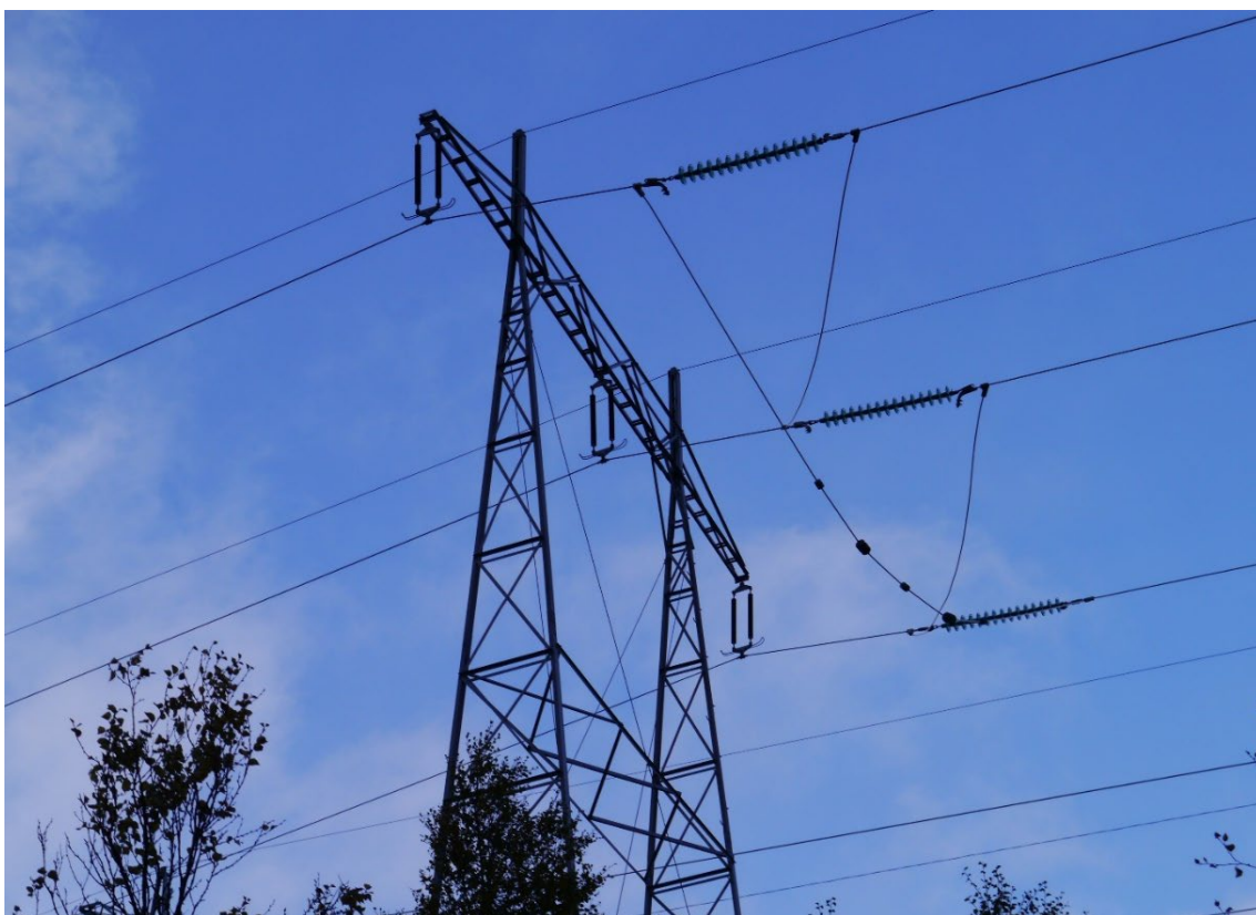
Figur 4.4-5 Revolveringsmast ved Bonsåsen (mast 38). Dobbel isolatorkjede i komposittmateriale. Fire av mastene på ledningen er revolveringsmaster 9 .
