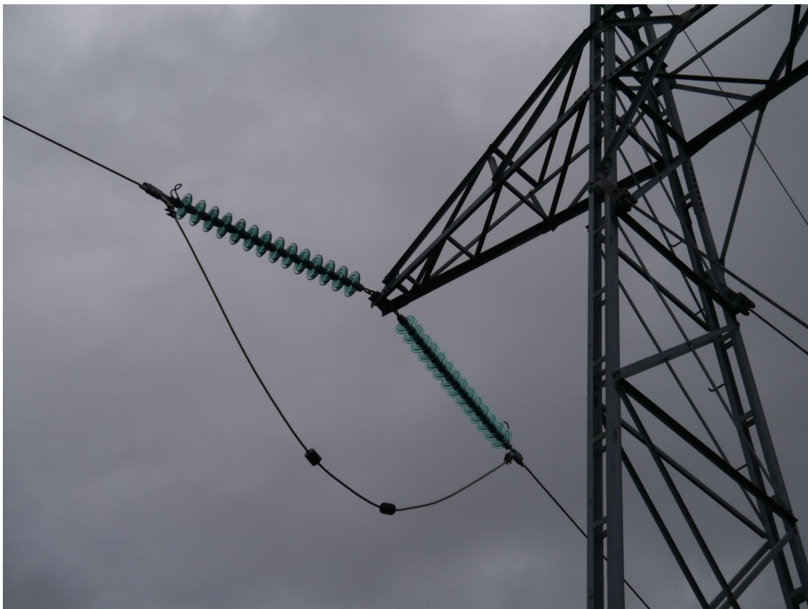
Figur 4.2-5 Vinkelforankringsmast (mast 14) med glassisolatorer. Forankringsmastene har kraftigere travers og mastebein med doble U-profiler.
