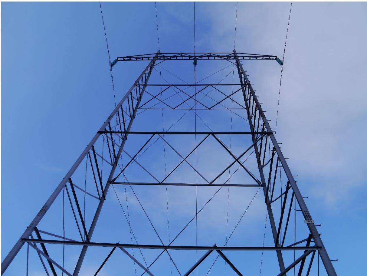
Figur 4.2-1 Typisk bæremast (mast 174) med hengeisolatorer av glass. Alle mastene med høyder mellom 15 og 25 meter har to bardunkryss (to etasjer), jf figur 4.2-2 og 4.2-4.
