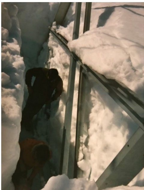
Figur 5-6 Utgraving av bæremast etter snøskred (Foto utlånt av Jan Erik Ingebrigtsen, Statnett)
