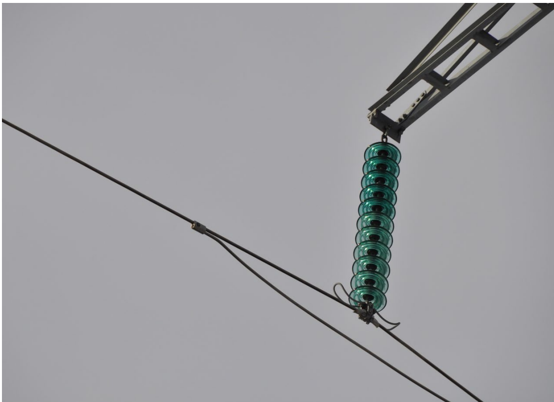
Figur 4.4-6 Hengeisolator NTP 33045 av glass på bæremast. (Kilde: NVE)
