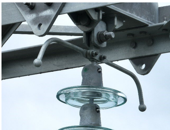
Figur 28 Gnisthorn mot mast, samt nøytrale isolator-skåler.
