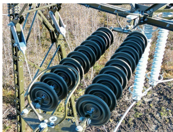
Figur 31 Kamouflerte isolatorskåler på en forankringsmast.
