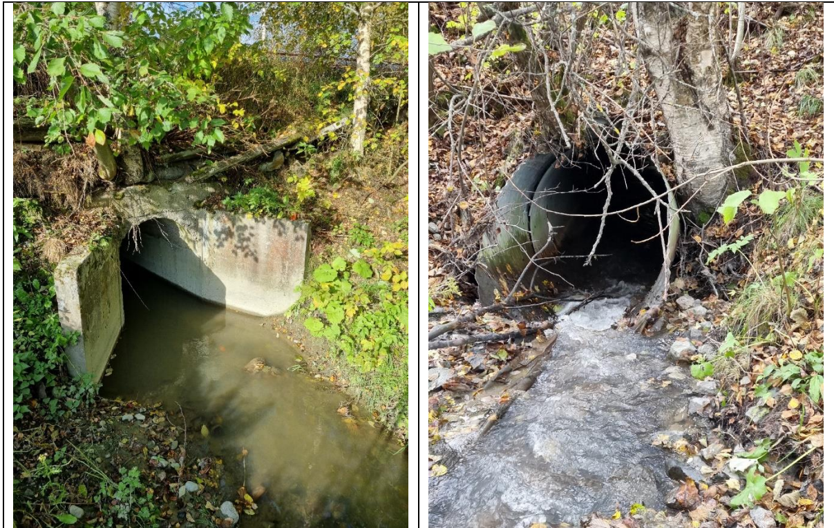
Figur 5-1: Bildet til venstre viser kulvert under jernbanen. Størrelse B: 110 cm, H: 150 cm. Bildet til høyre viser kulvert under Blåsmovegen, Ø1400.
