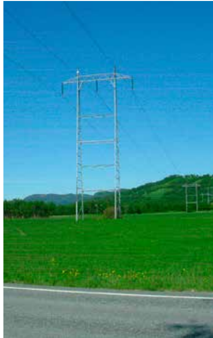
Eksisterende ledning i Melhus
