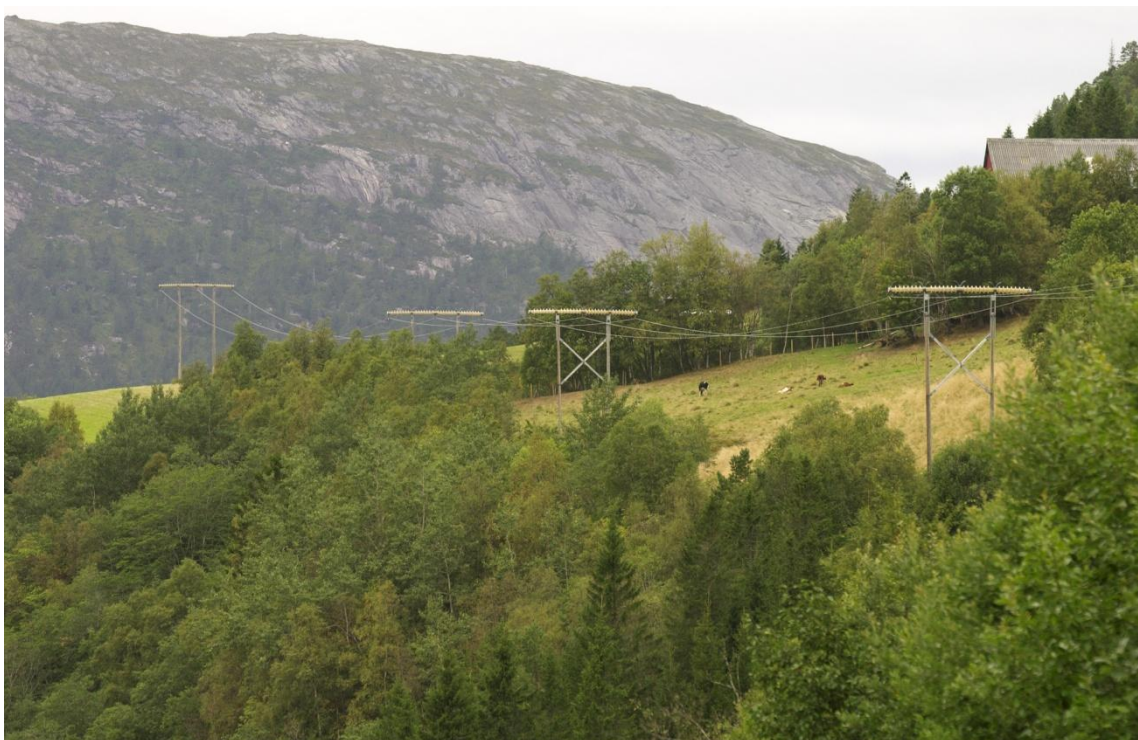
Figur 4. Sætergardsdalen. Kryssavstivingene og isolatorene i traversen gjør disse mastekonstruksjonene mer iøynefallende.
