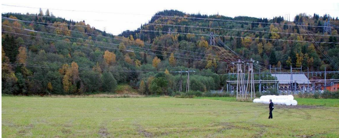
Figur 56. Område for utvidelse av Blåsmo transformatorstasjon.
