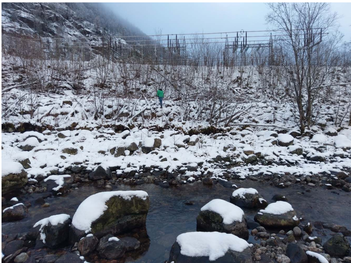
Figur 4. Skråningsvernet er i dårlig stand og må legges på nytt. Personen i bildet står omtrent på høyde med vannstanden for 1000-årsflom.
