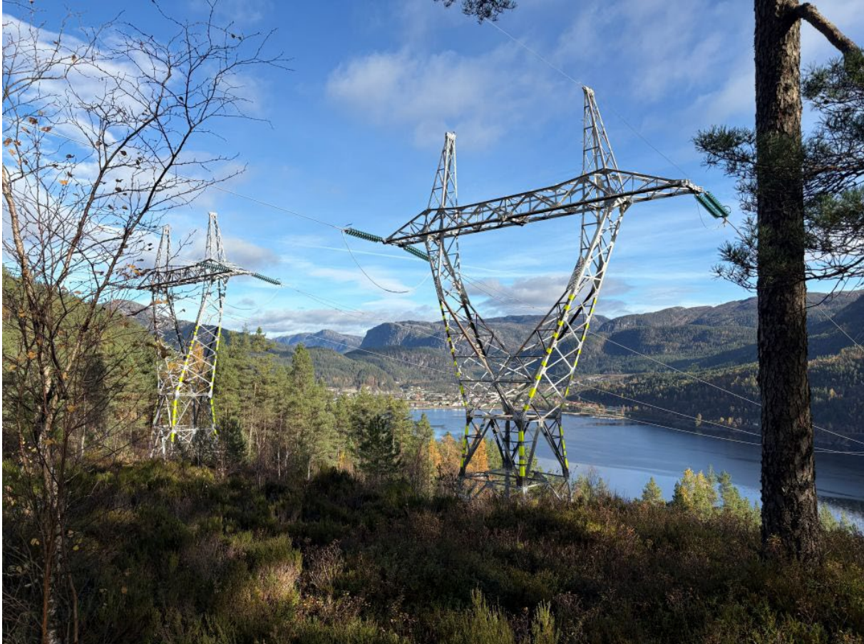
Figur 3 Eksisterende 300 kV forbindelse fra Tonstad koblingsstasjon til Fagrafjell transformatorstasjon på vestsiden av Sirdalsvatnet innenfor Øykjeheia naturreservat. Statnett søker om å rive denne kraftledningsforbindelsen.
