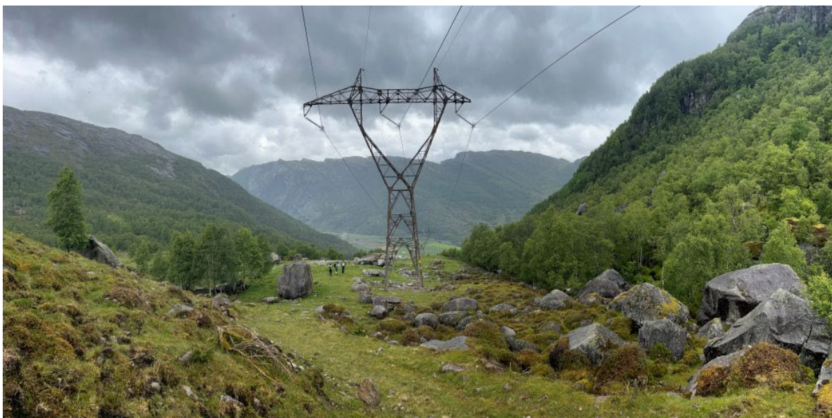
Figur 9 Eksisterende 300 kV forbindelse er bygget på 1970-tallet. Bildet er fra Ørdsalen i Bjerkreim kommune.
