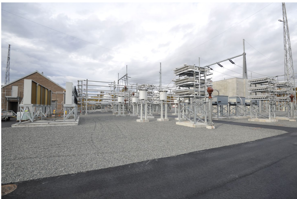
Figur 8: Det er avsatt areal på stasjonsområdet for etablering av SVS anlegg. Bildet viser tilsvarende SVS anlegg som er etablert i Sogndal. Kilde: Statnett 2023
