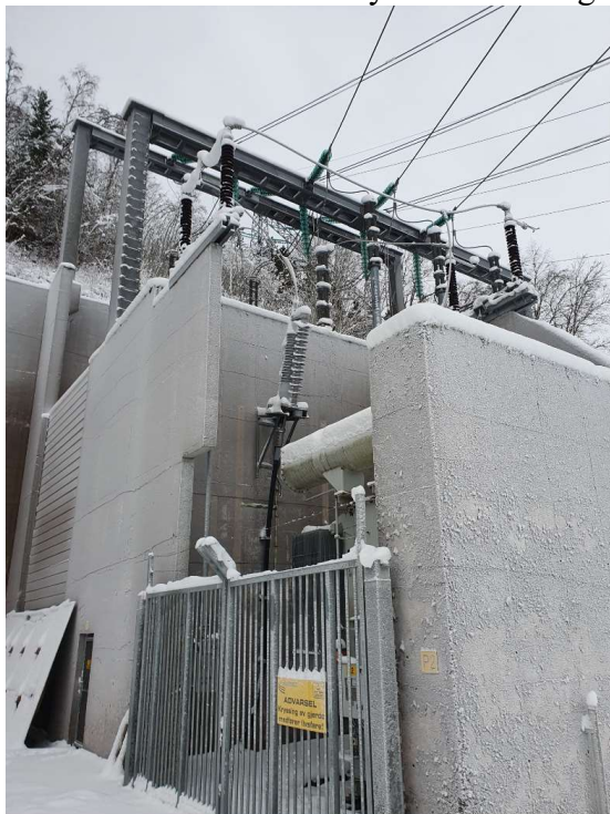
Figur 2: P-Spole nærmest i sjakt, og transformersjakt i bakgrunn
