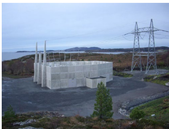
Figur 3: Eksempel på betongsikret muffeanlegg.
