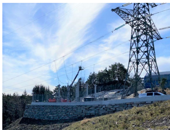
Figur 4: Eksempel på åpent muffeanlegg
