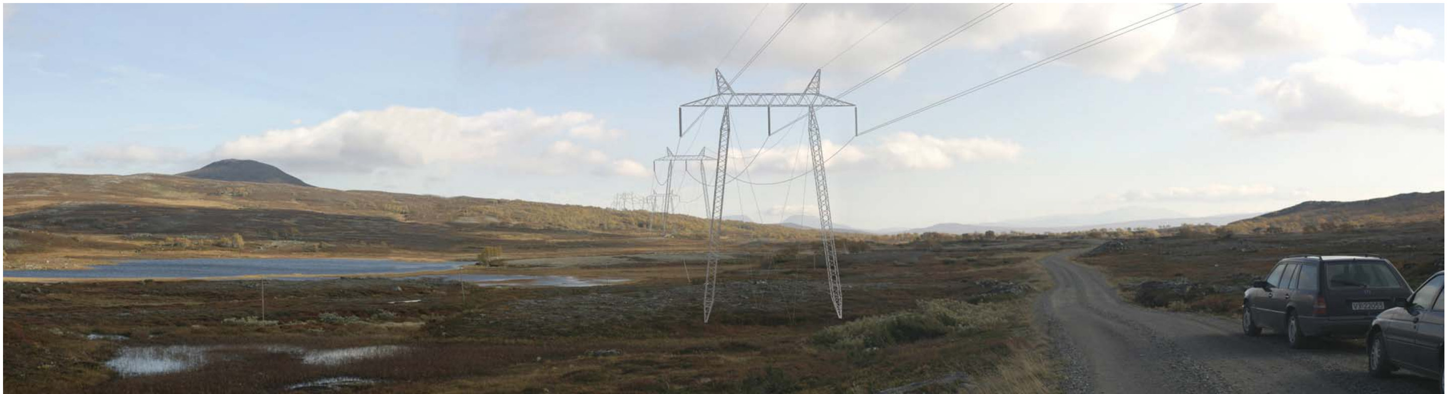
Visualisering fra Kroessdurrie mot øst. Alternativ 1.0 med utvendig bardunerte master. Foto og visualisering: Trond Simensen, SWECO Grøner
