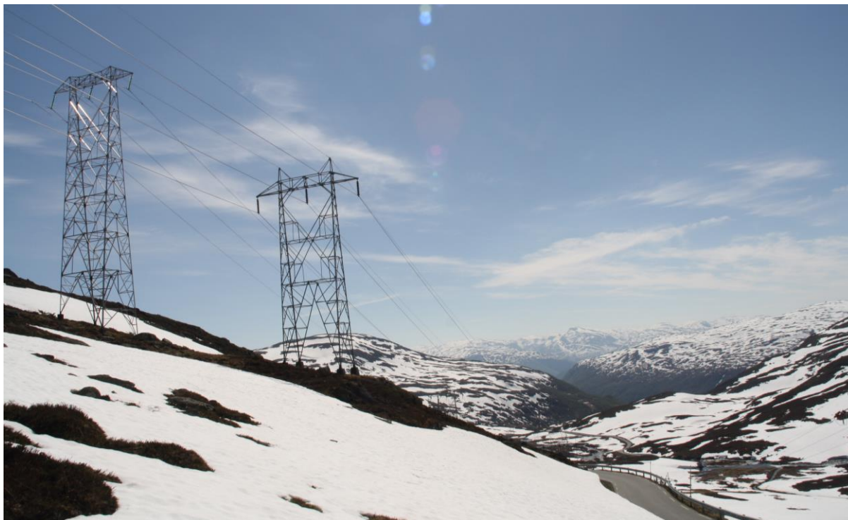
Figur 3-39. 132 kV master (Fortun- Øvre Årdal). På grunn av motlyset fremstår begge mastene ganske mørke mot den lyseblå himmelen. I klart vær med sol vil det oppstå refleksjoner fra aluminiumsmasten til venstre. Foto: Statnett.
