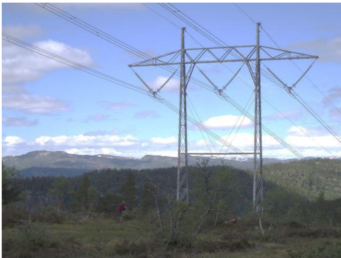
Figur 2. Standard 420 kV portalmast med isolatorkjeder i V-form og triplex linetverrsnitt (3 strømførende liner pr. fase). Foto: Statnett
