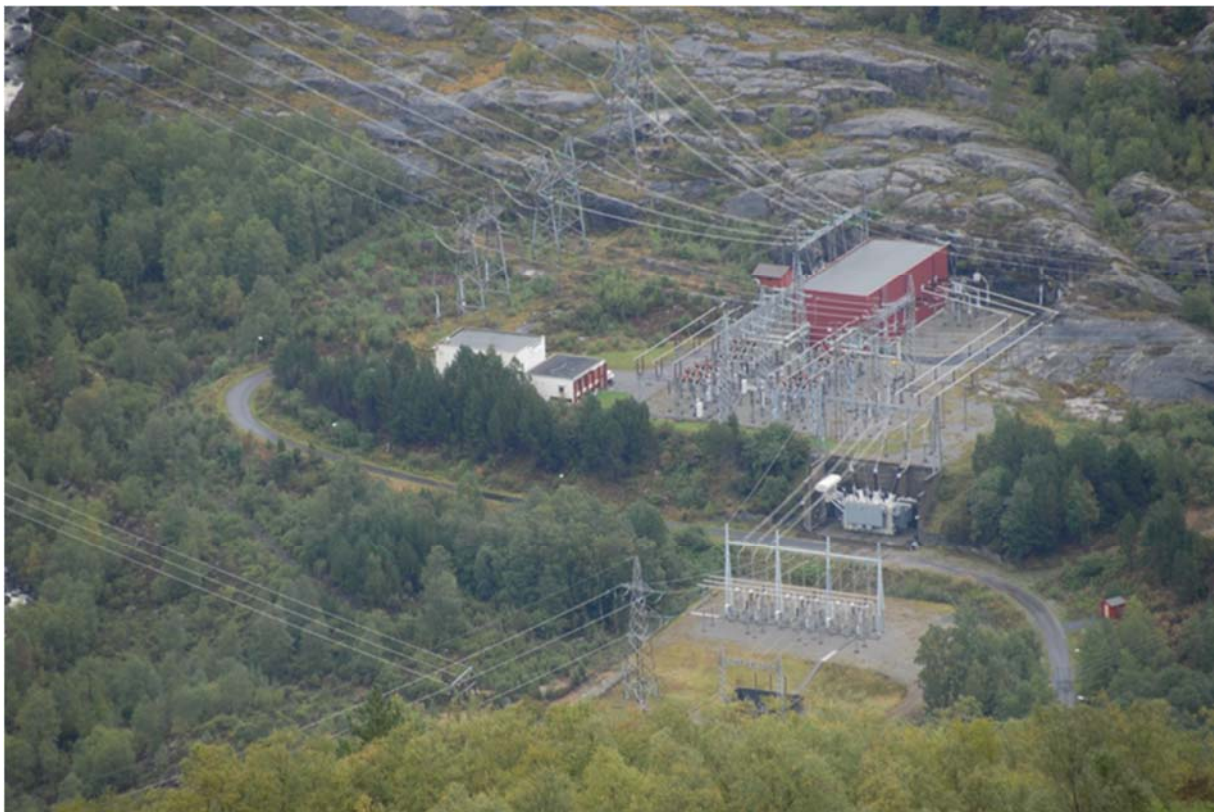
Figur 8. Lyse transformatorstasjon med dagens 300 kV-anlegg. Dagens ledning til Duge går ut fra stasjonen lengst opp og mot venstre.
