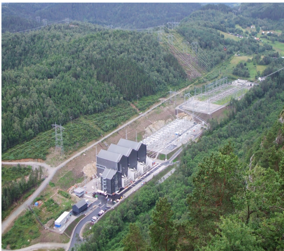
Figur 1. Dagens anlegg i Feda. Strømretteranlegg NorNed 1 med ventilhall nærmest, filteranlegg for NorNed 1 i midten og 300 kV koblingsanlegg lengst bort. 300 kV koblingsanlegget vil kunne bli sanert som en konsekvens av et nytt 420 kV anlegg ved Hestsprangvatnet.
