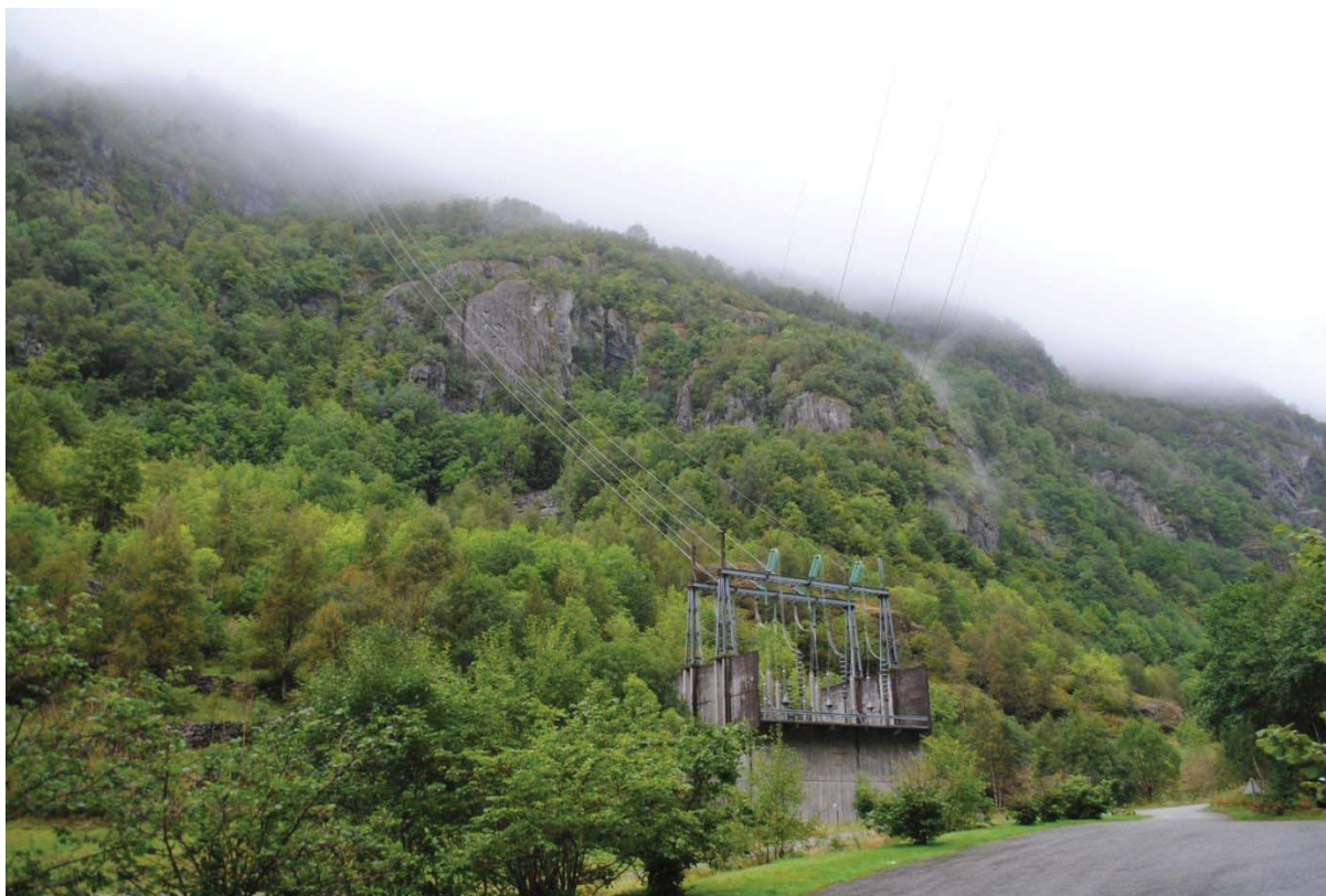
Figur 21. Eksisterende 300 kV GIS-anlegg i Hylen.
