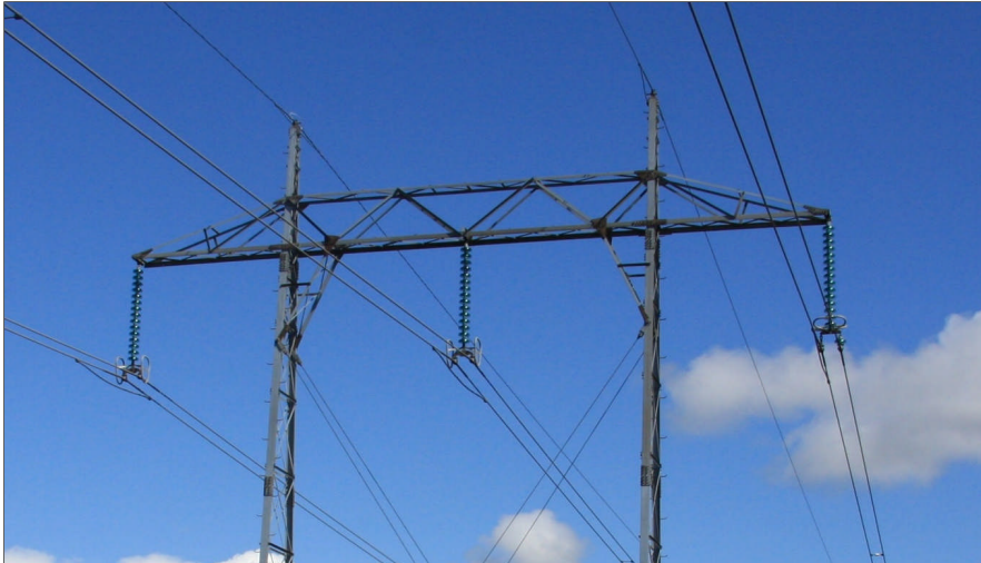
Figur 2. Bildet viser en 300 kV bæremast med to liner pr. fase (duplex). De strømførende linene er hengt opp i masta med isolatorkjeder, som normalt består av 14 ledd. Ved spenningsoppgraderingen til 420 kV vil isolatorkjedene i de fleste mastene bli forlenget med 2-3 ledd.
