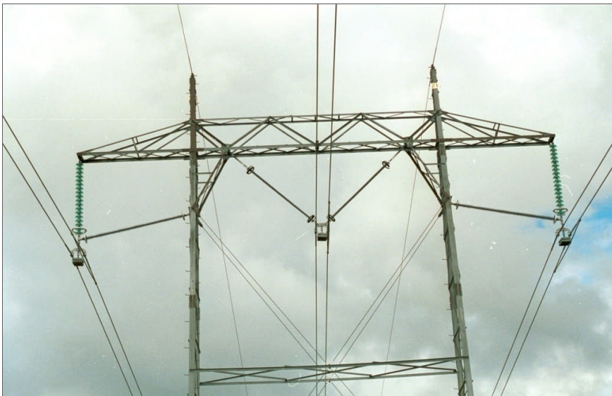
Figur 3. Bildet viser en mast med isolatorer i en såkalt V-kjede i midten og L-kjeder på sidene. Et mindre antall master på strekningen Kristiansand-Feda kan få slike isolatorer. Dette gjøres i så fall for å hindre at linene svinger sideveis, med fare for overslag mot mastebeina eller barduner.
