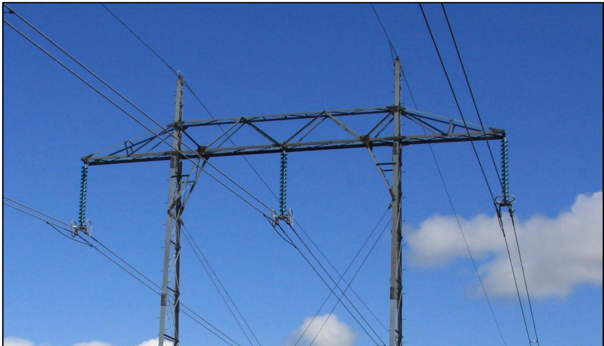
Figur 5.6.1. Bildet viser en 300 kV bæremast med to liner pr. fase (duplex). De strømførende linene er hengt opp i masta med isolatorkjeder, som normalt består av 14 ledd. Ved spenningsoppgraderingen til 420 kV vil isolatorkjedene i de fleste mastene bli forlenget med 2-3 ledd.
