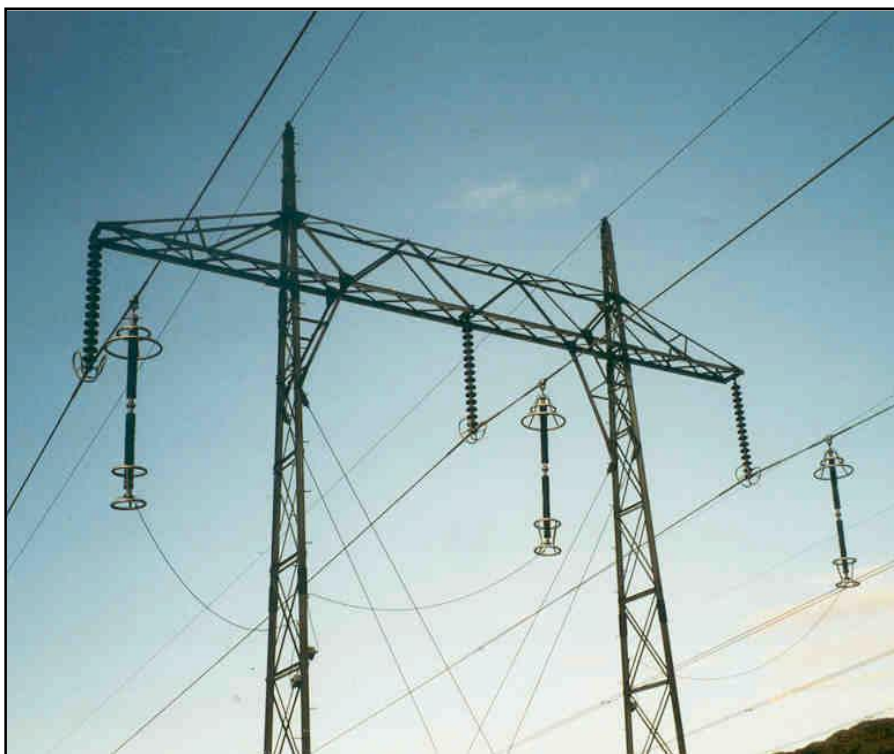
Figur 5.6.2. Bildet viser såkalte linjeavledere, som henger ned fra de strømførende linene. Slike avledere vil trolig bli montert i enkelte master ved inngang til stasjonene.
