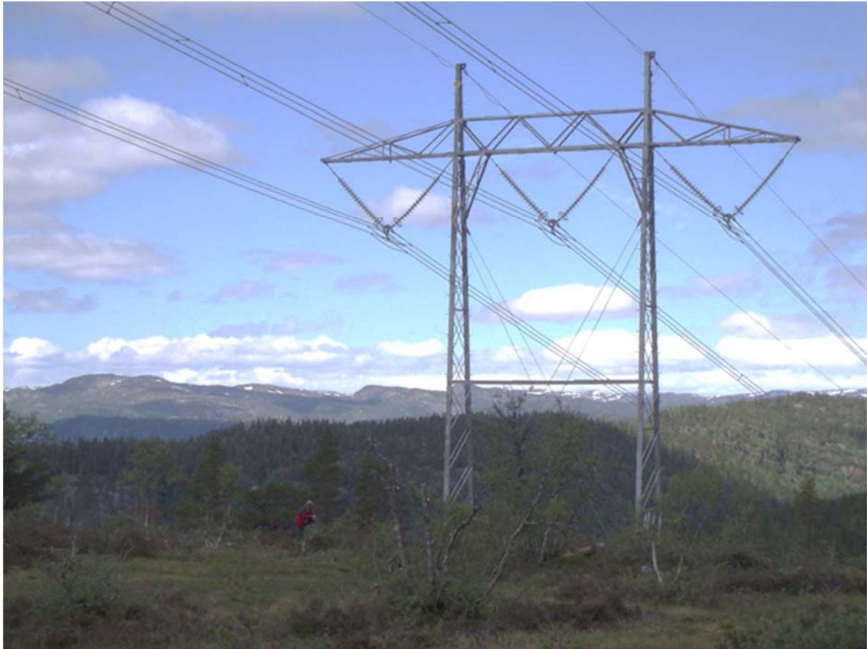
Figur 3: Bilde av 420 kV bæremast med tre liner per fase
