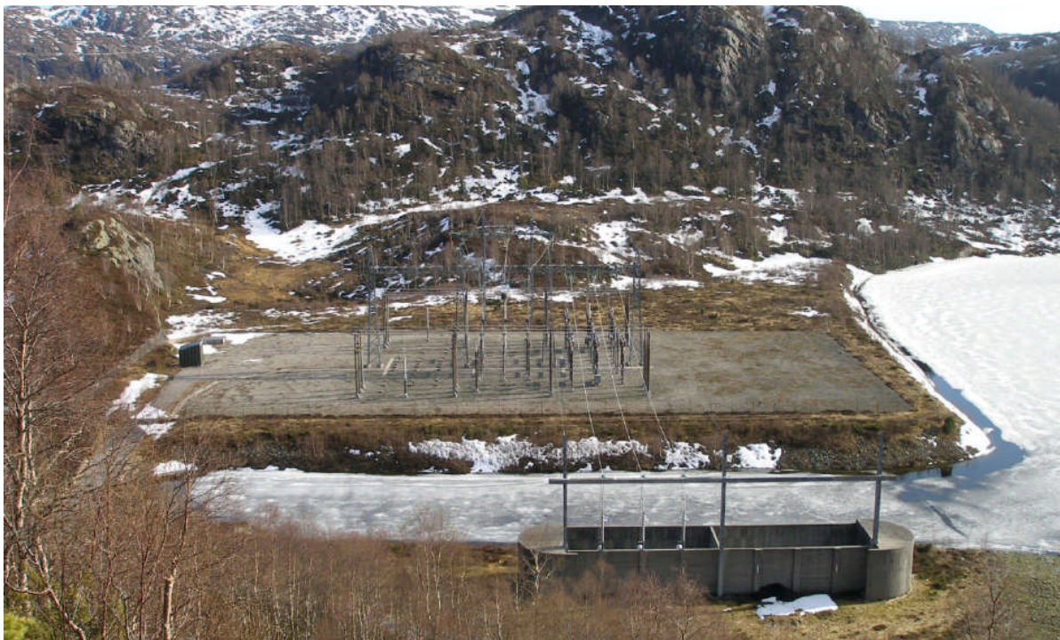
Figur 8. Bildet viser eksisterende koblingsanlegg ved Tjørhom [3]
