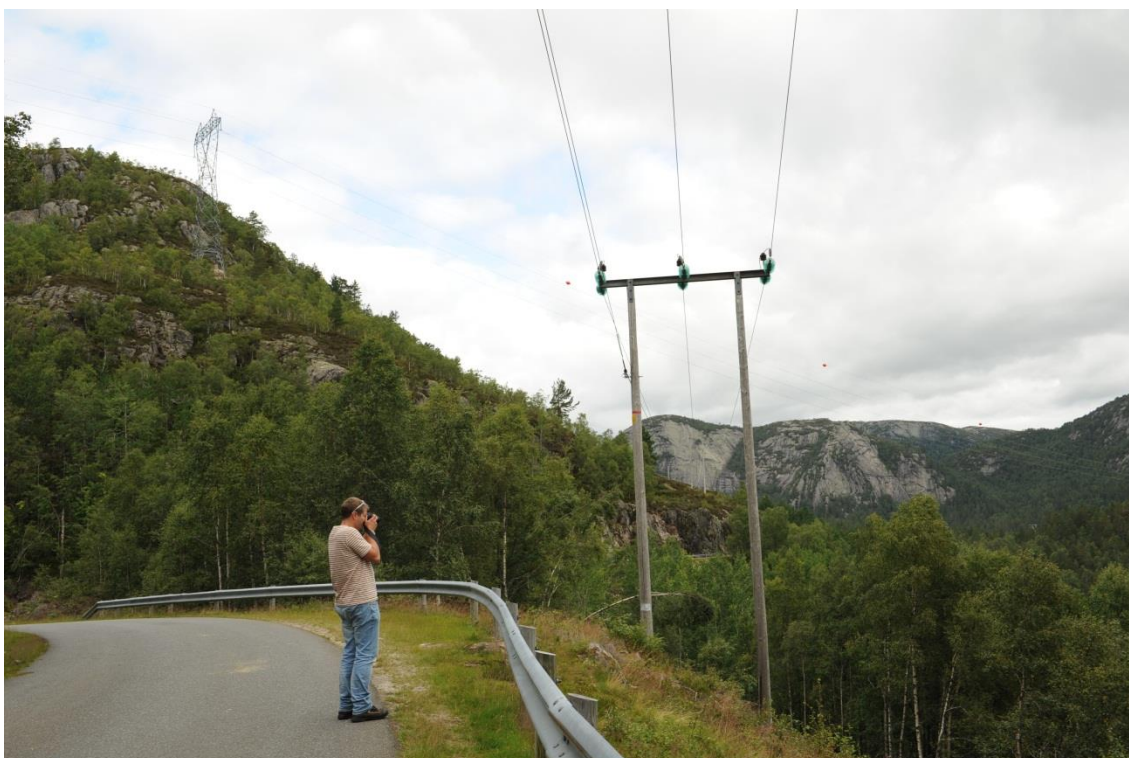
Figur 12. Eksisterende 300 kV og 22kV møtes ved nordenden av Homstølvatnet
