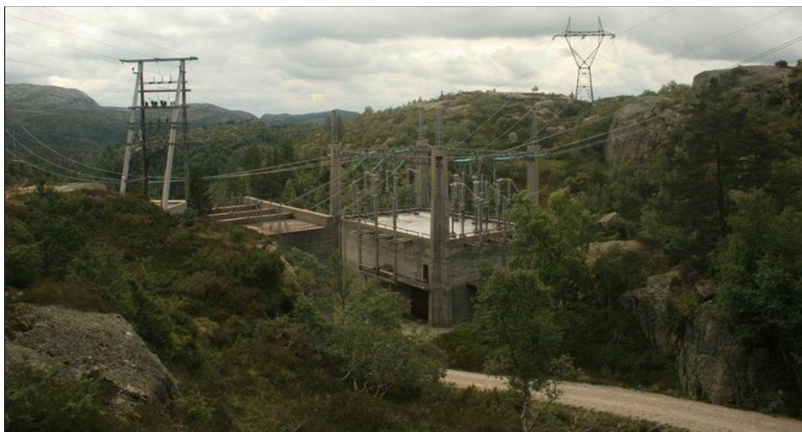
Figur 8. Dagens Solhom stasjon hvor eksisterende ledning fra Tonstad føres inn til stasjonen via gaffelmasten til høyre i bildet. Den nye ledningen føres inn til stasjonen til venstre for bestående mast.
