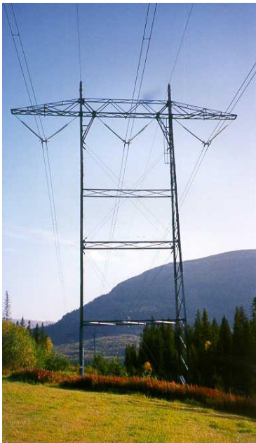
Figur 3. Statnetts standard bæremast med isolatorkjeder i V-form. Foto: Statnett
