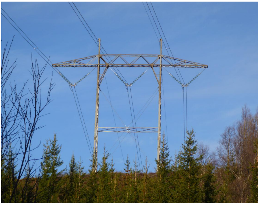
Figur 1. Oppisolering fra 300 til 420 kV ved at isolatorkjedene er forlenget. Øverst del av isolatorkjedene har grå sioaltorskåler, som er for forlengelsen. Opprinnelig isolatorer er grønnfarget. Bildet viser mast med isolatorer i V-form. Endringen vil bli tilsvarende for I-formede isolatorkjeder.
