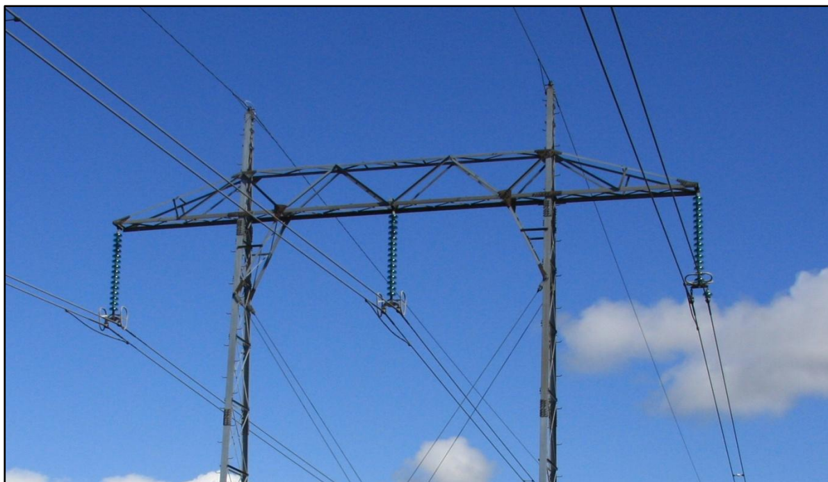
Figur 8. Bildet viser en 300 kV bæremast med to liner pr. fase (duplex). De strømførende linene er hengt opp i masta med isolatorkjeder, som normalt består av 14 ledd. Ved spenningsoppgraderingen til 420 kV vil isolatorkjedene i de fleste mastene bli forlenget med 2-3 ledd.
