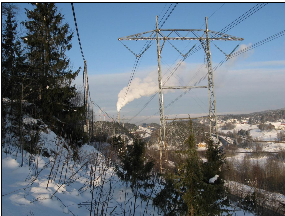
Figur 13. Skjerming med strømsløyfe ved Nyjordet i Oslo. Strømsløyfen (til venstre i bildet) er montert mellom kraftledningen og boligbebyggelsen.
