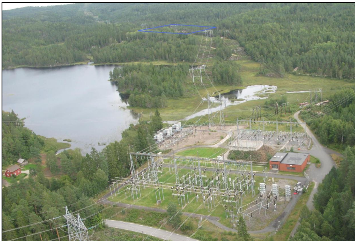
Figur 5. Arendal transformatorstasjon. 300 kV koblingsanlegget i forgrunnen vil bli sanert etter at det nye stasjonsanlegget er satt i drift. Omtrentlig lokalisering av planlagt stasjonsutvidelse er vist med blå firkant i bakgrunnen.
