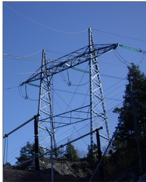
Figur 6: Masttypen som prosjekteres på Filtvet og Brenntangen
