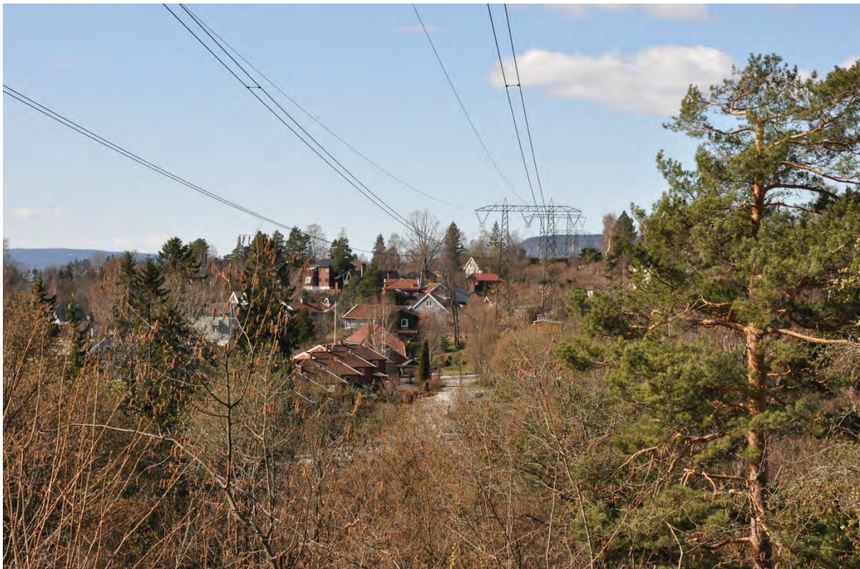
Figur 5-26 Luftspenn over Lysakerelva sett fra øst mot vest. Foto: Sweco Norge AS.
