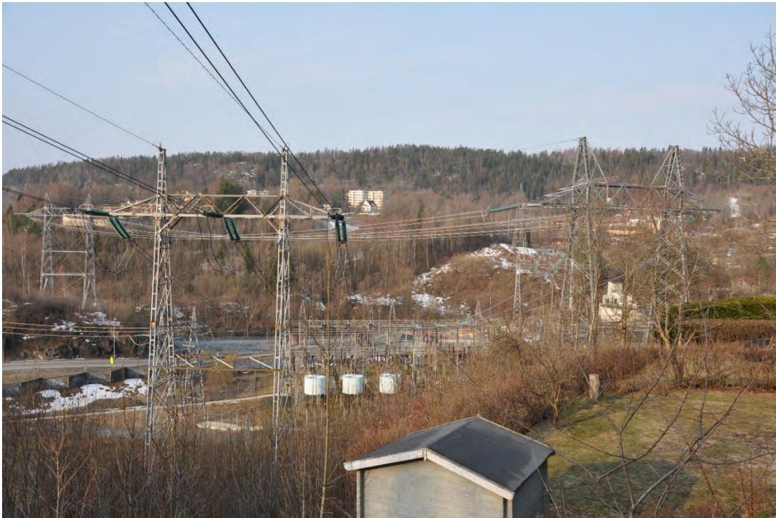
Figur 5-2 Hamang transformatorstasjon sett fra øst mot vest. Foto: Sweco Norge AS.
