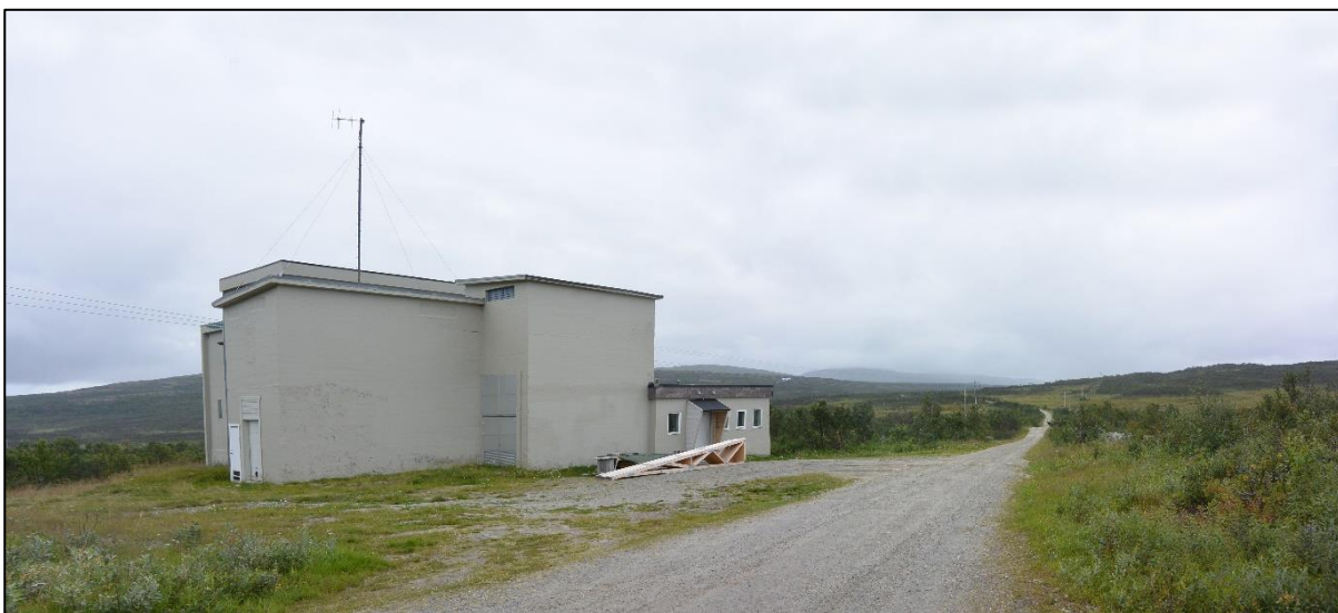
Figur 4-32. Smørffjord transformatorstasjon før utvidelse.
