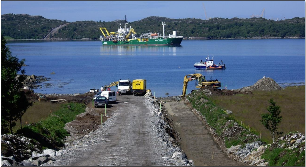
Figur 2-3. Eksempel på anleggsbelte for 420 kV jordkabel med ett kabelsett + reservekabel (totalt 4 kabler) i overgangen mellom jordkabel og sjøkabel. Foto: Statnett.
