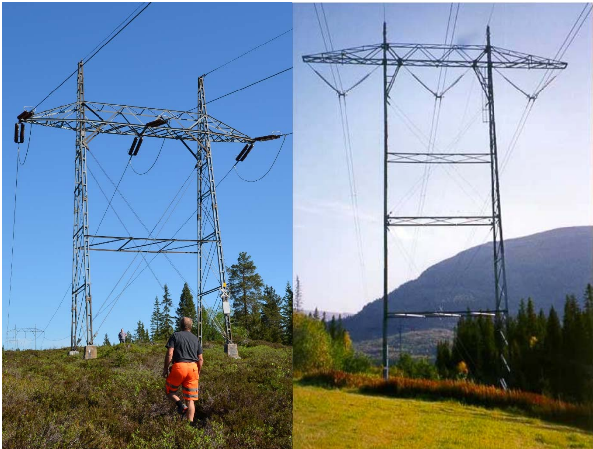
Figur 5 Bilde av Statnetts standard portalmast. Forankringsmast (til venstre) og bæremast.
