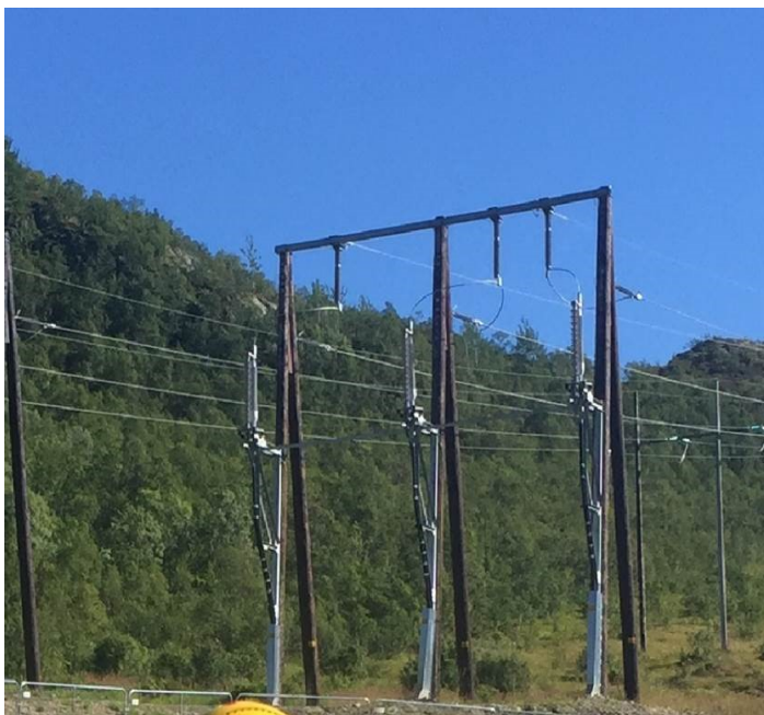
Figur 4: Eksempelbilde av kabelendemast. Denne masten står ved Kvitfossen transformatorstasjon på ledningen 132 kV Kvifossen-Kanstadbotn
