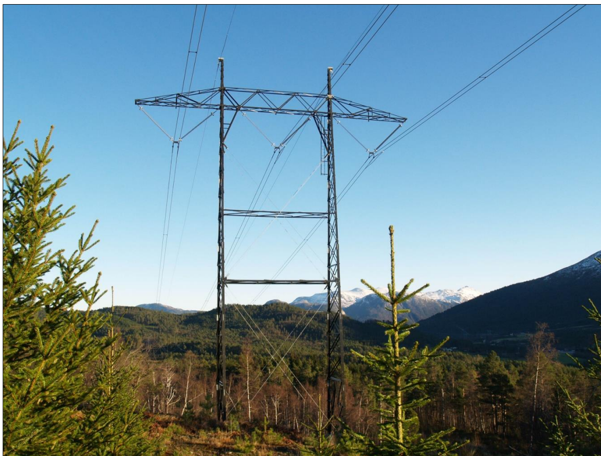
Figur 25. Farget 420 kV portalmast med isolatorkjeder av komposittmateriale.
