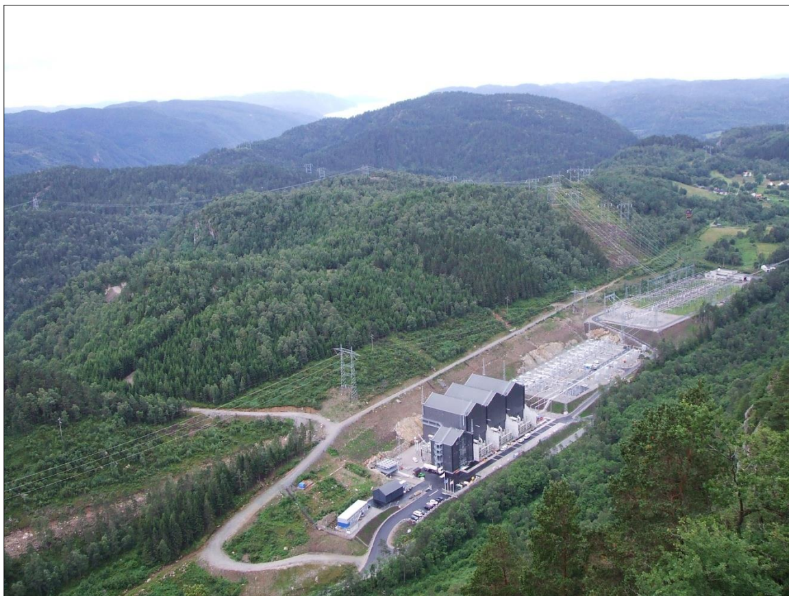
Figur 24. Strømretteranlegget for NorNed-kabelen på Feda i Vest-Agder.
