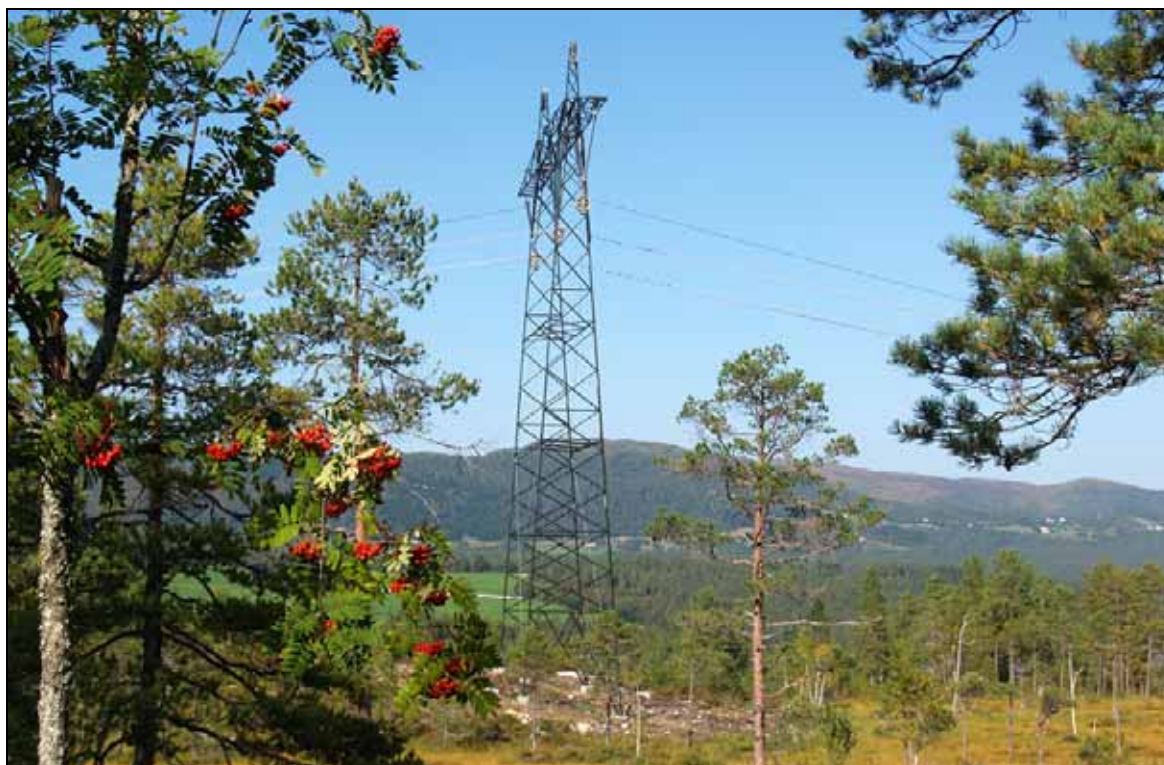
Figur 84: Kamuflasje av kraftledning. Bildet viser en fargesatt kraftledning som er under montasje. Masten er malt mørk olivengrønn/brun for å etterligne skyggene i terrenget. Isolatorene er her av kompositt og linene er mattede. Ledningen er under montasje, og det henger derfor montasjeblokker for linene i masta.
