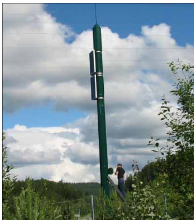
Figur 85: Automatisk flyvarslingssystem (radiomarkør). Bildet viser en radarmast av merket OCAS – Obstacle Collision Avoidance System. Dersom fly eller helikopter har retning mot spennet gis lydvarsel på pilotens radio, samtidig som lamper i mastetoppene starter å blinke. En selvstendig laveffekts radarmast settes opp på en åsrygg i nærheten av luftspennet. Radarmasten vil i gjennomsnitt være ca 17 meter høy og ha en diameter ved bakken på ca 50 cm, avhengig av topografien og vegetasjonen i området.
