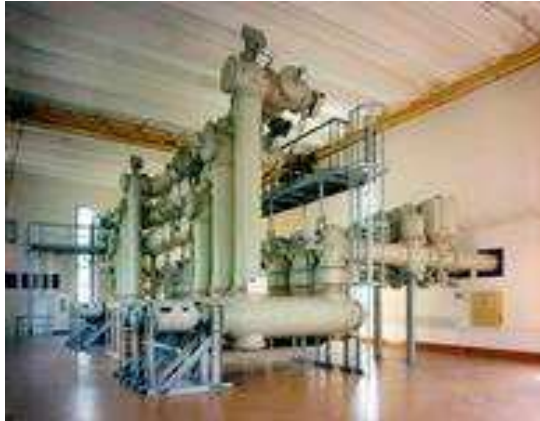
Foto 3-4 Typisk GIS anlegg (SF 6 isolert) (kilde ABBs nettside: http://www.abb.com/ )
