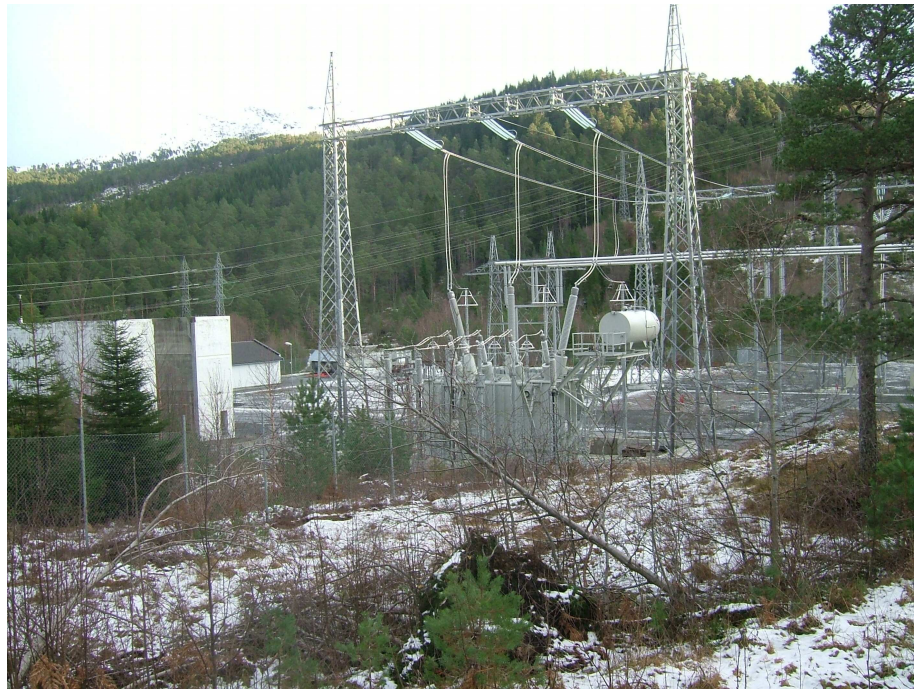
Foto 6 – 4 Ørskog Transformatorstasjon (foto Multiconsult)
