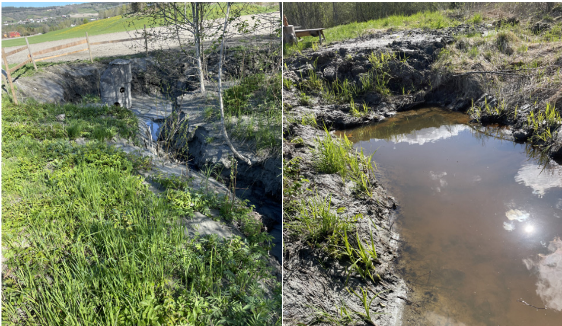
Figur 2 Området innerst i Engmovegen. Bekken har erodert og masser har lagt seg opp i bekkeleiet lenger ned (høyre)
