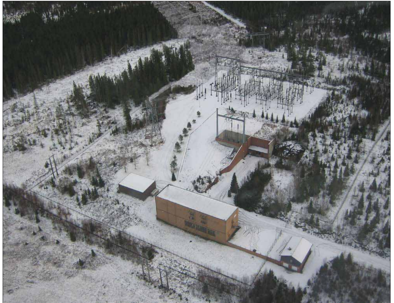
1. Namsen. Skage trafostasjon. 420 kV-ledningen går parallelt med eksisterende 300 kV-ledning. Eksisterende transformatorstasjon vil bli utvidet med ett bryterfelt.
