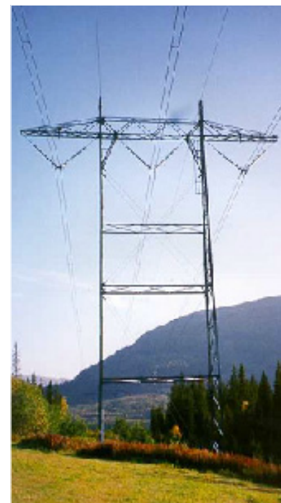
Portalmast for 420 kV ledning.
