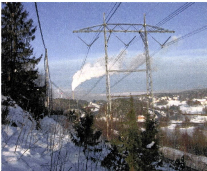
Figur 10: NVE kjenner bare til én skjermledning for kraftledninger i Norge – den er satt opp ved Nyjordet i Oslo. Skjermledningen går i en sløyfe rundt 420 kV-ledningen og skjermer bebyggelsen (som ligger til venstre, utenfor bildet). Bildet er hentet fra søknaden.
