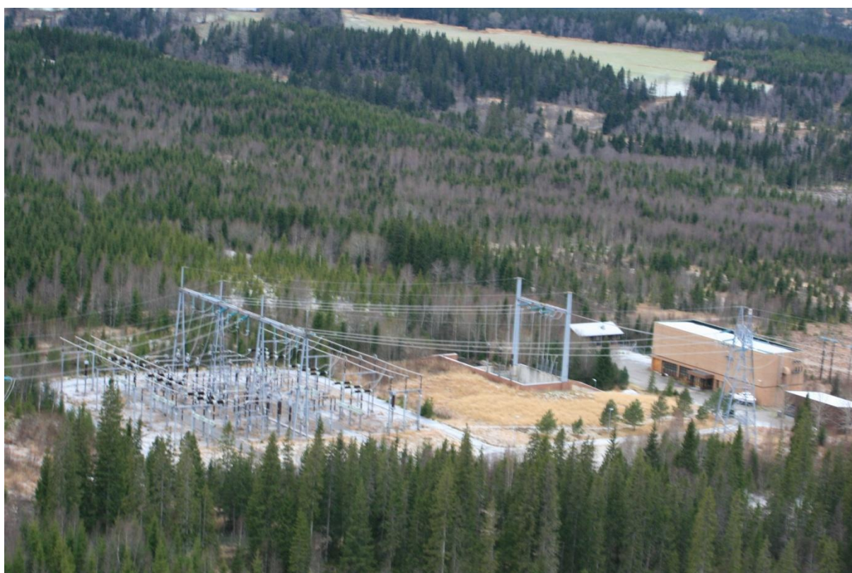
Figur 11. Dagens Namsos transformatorstasjon i Overhalla kommune sett mot vest.
