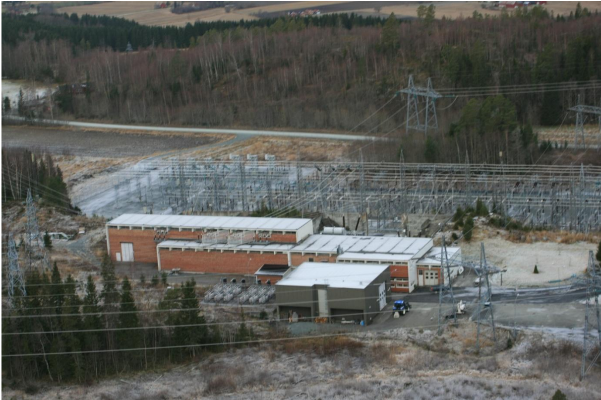
Figur 6. Verdal transformatorstasjon i Verdal kommune sett mot nordvest. Planlagt utvidelse/ombygging av stasjonsanlegget vil skje i forlengelsen av anlegget til venstre i bildet.
