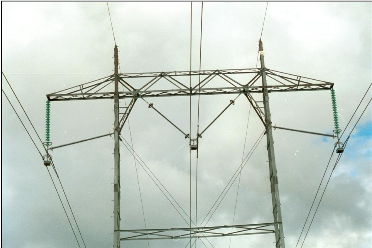
Figur 17. Bildet viser en mast med isolatorer i en såkalt V-kjede i midten og L-kjeder på sidene. Et mindre antall master på strekningen Verdal – Ogdal - Namsos kan få slike isolatorer. Dette gjøres i så fall for å hindre at linene svinger sideveis, med fare for overslag mot mastebeina eller barduner.
