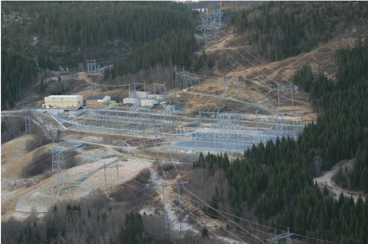
Figur 5. Klæbu transformatorstasjon i Klæbu kommune, med kontrollhus m.m. til venstre i bildet, 300 kV anlegget i midten av bildet, og 420 kV anlegget i høyre del av bildet. Midt i nedre del av bildet ser vi eksisterende 300 kV-ledning Klæbu – Verdal, og nede til høyre i bildet ser vi eksisterende 300 kV-ledning som kommer fra Strinda og krysser under 300 kV-ledningen Klæbu – Verdal. Til venstre i bildet ser vi 420 kV-ledningen som kommer fra Nea og krysser over eksisterende 300-ledning fra Verdal. Ved spenningsoppgradering av 300 kV-ledningen Klæbu – Verdal vil innføringen (ombygging av tre master) til stasjonen flyttes noe mot nordøst slik at man unngår å krysse 420 kV-ledningen til Nea, og det vil etableres et nytt 420 kV-ledningsfelt mot granskogen til høyre i bildet. Utvidelsen av stasjonsanlegget vil skje innenfor Statnetts eiendom, mens nødvendige omlegginger av 300 kV-ledningen Klæbu – Verdal vil berøre eiendommene mellom siste mast øst for Nidelva og Klæbu transformatorstasjon.
