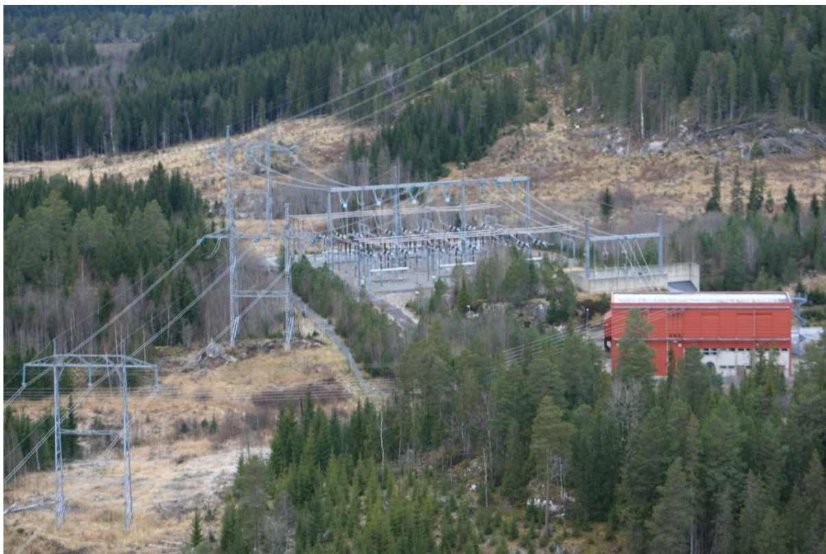
Figur 9. Bilde som viser dagens Ogdal transformatorstasjon mot nordøst.
