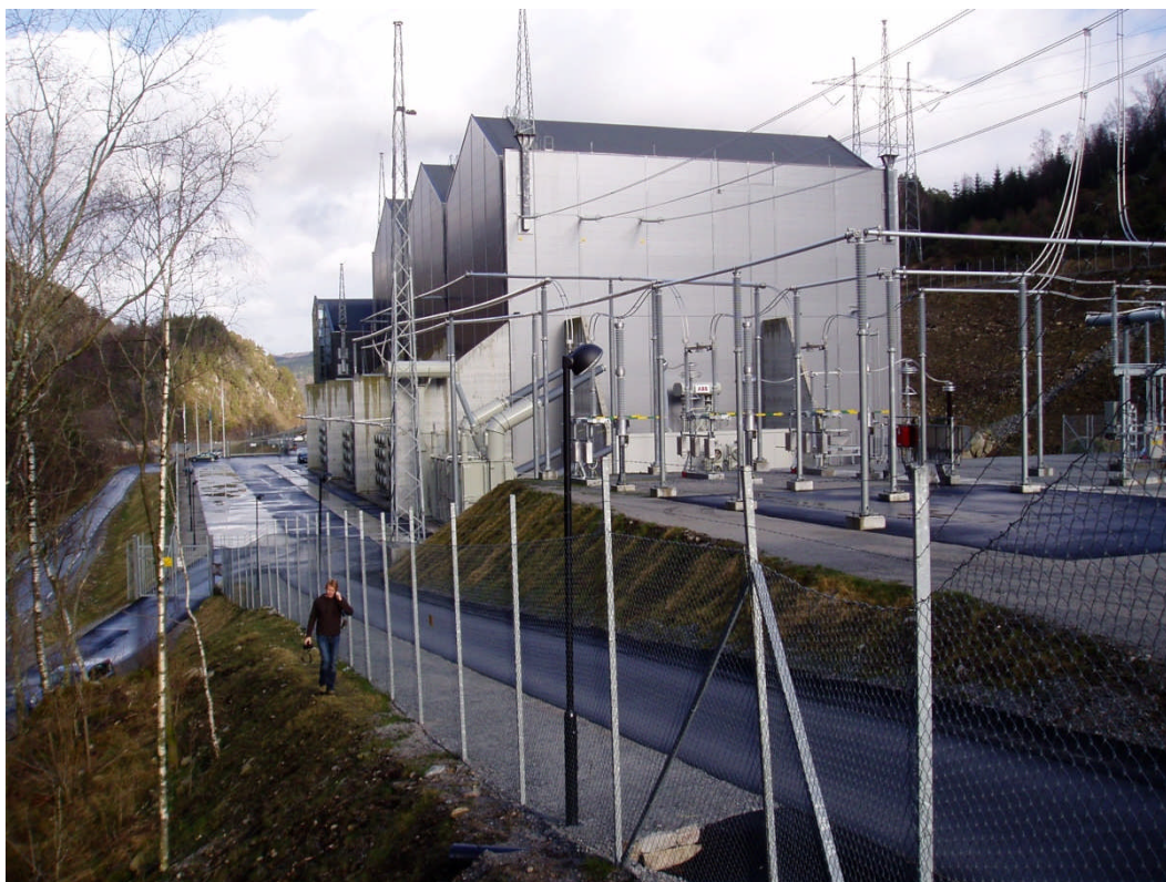
Figur 6-8. Eksempel på omformeranlegg. Foto: Ask Rådgivning
