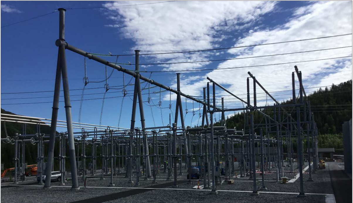
Bilder av kontrollhus øverst og garasje/lager og kontrollhus i midten. Nederste bilde viser et standard 420 kV utendørsanlegg med innstrekkestativ (høyest) i midten og samleskiner og apparatanlegg.
