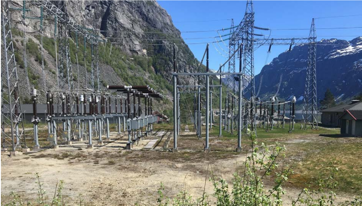
Figur 3: Dagens anlegg i Åsen transformatorstasjon
